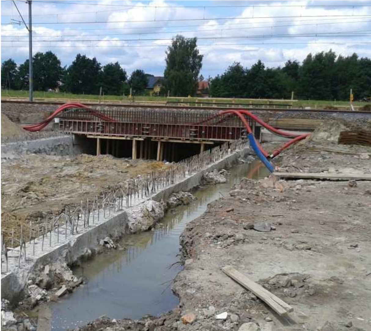
Budowa wiaduktu drogowego w Chylicach – skrzyżowanie linii kolejowych nr 1 i 4 w km. 34+075 z ulicą Kukuczki. Stan z dnia 19 czerwca 2015 r. Źródło: Zdjęcie pozyskano w ramach kontroli NIK.
